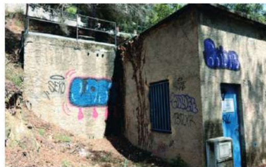
El dipòsit de la urbanització de Can Puigdemir és el més afectat per la manca d'aigua a Vallgorguina
